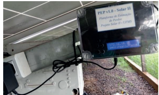
Fig. 11. Protótipo PeP1.0 instalado na UFV-UFMS.
