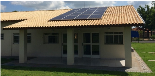
Fig. 15. Geração fotovoltaica instalada na UNESP-CCI de Ilha Solteira.
