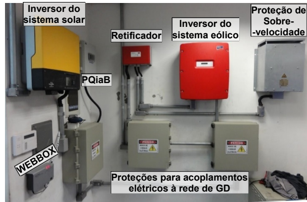
Fig. 18. Equipamentos de condicionamento de energia, proteção e medição para os sistemas de GD instalados na Elektro de Guarujá-SP.
