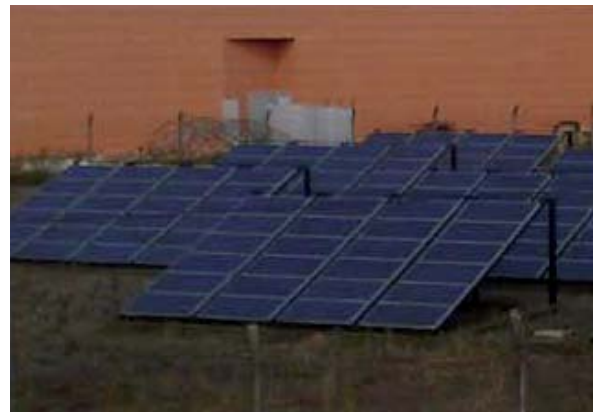
Fig. 11. Vista parcial dos painéis do SGD fotovoltaico instalados no Campus da UFJF.
