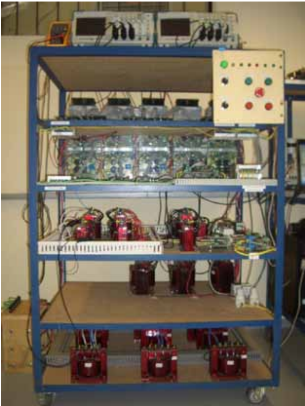
Fig. 15. Protótipo do conversor multinível – Vista geral: Conversores, Indutores e cabeamento.
